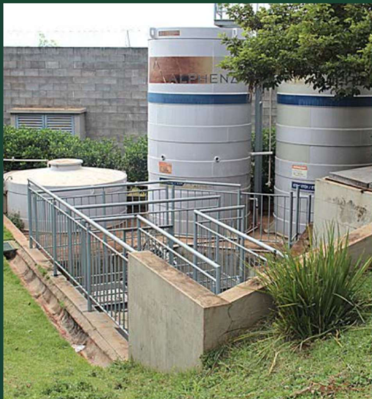
Estação de tratamento de efluentes (ETE) da fábrica da BYD em Campinas (SP).
