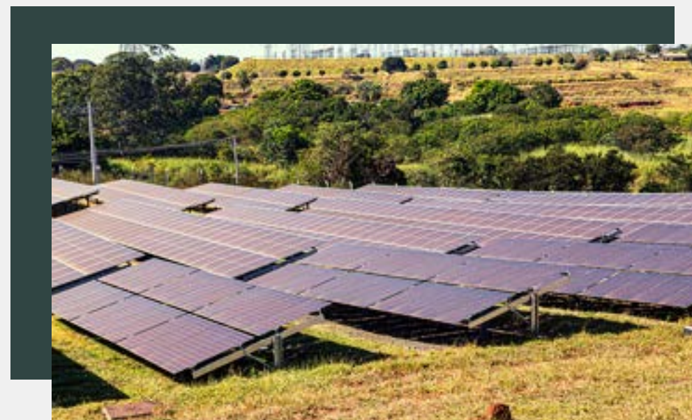
Usina fotovoltaica da BYD, em Campinas (SP)
