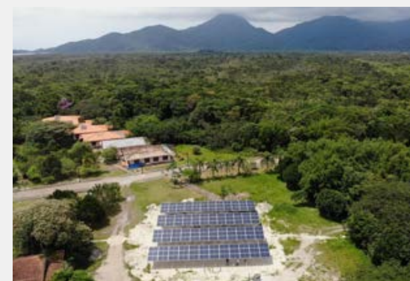
Usina solar no Parque Estadual Ilha do Cardoso (SP)
