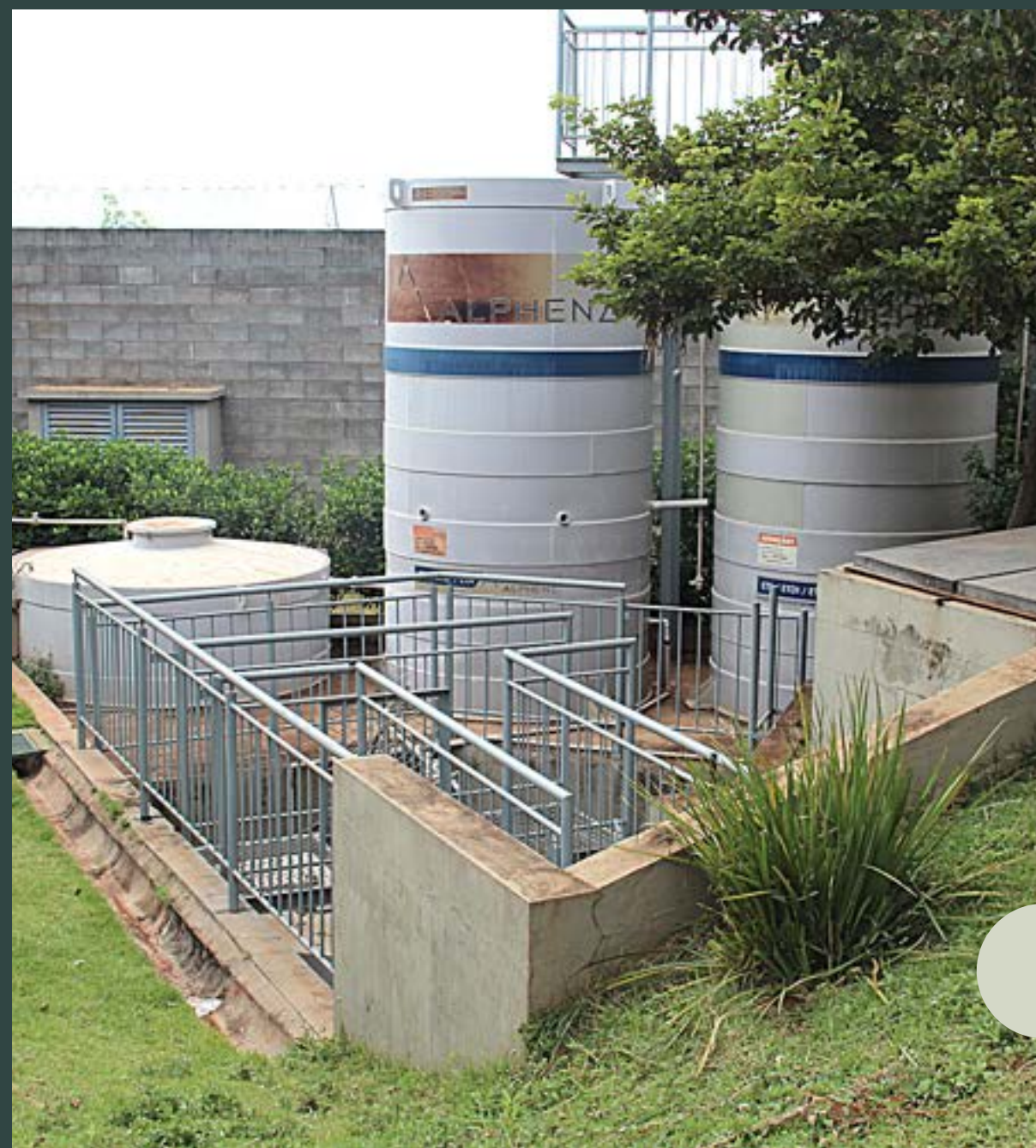
Estação de tratamento de efluentes (ETE) da fábrica da BYD em Campinas (SP).
